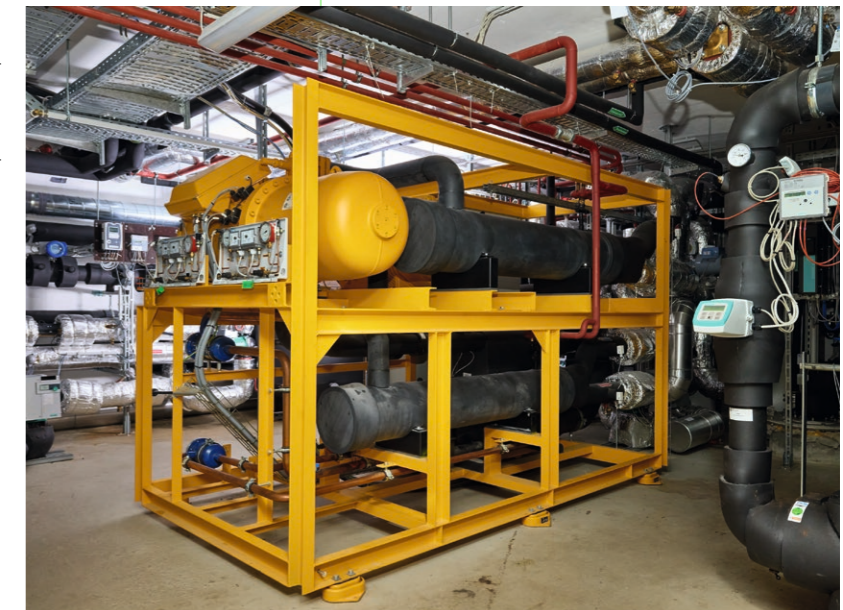
Die Wärmepumpe eines ASCR-Testbeds
