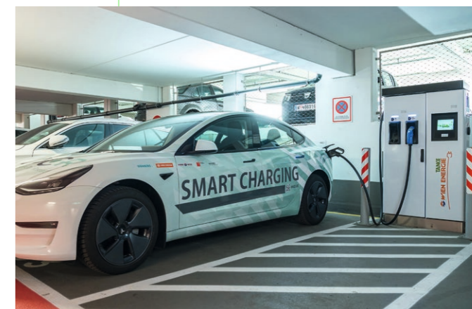
Forschung zum elektrischen Fahren – in der SeeHub-Garage wurden verschiedene Ladesysteme unter realen Bedingungen getestet.
