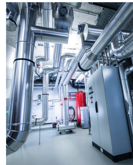
Das Herzstück eines Gebäudes ist die Technikzentrale.
